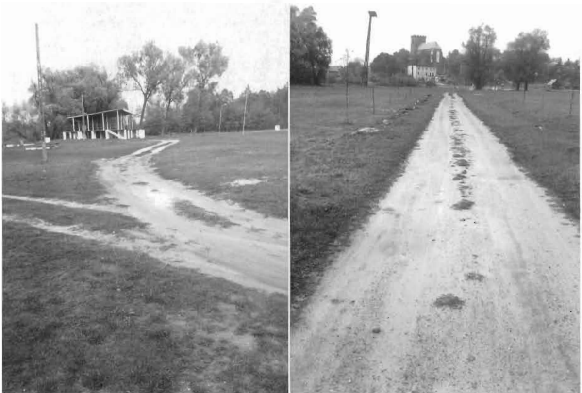
Zdjęcia nr 4 – Droga dojazdowa do boiska – brakujące 300 mb.
