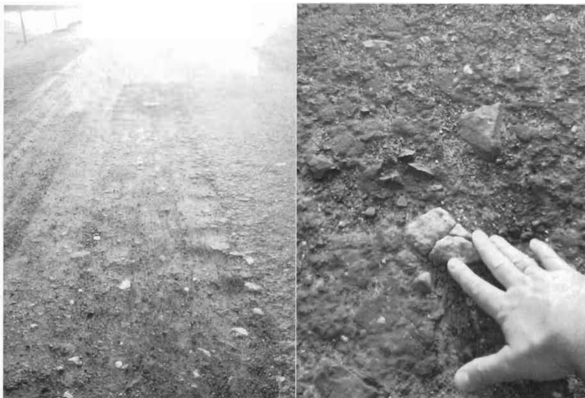
Zdjęcia nr 2 – Droga dojazdowa do boiska – destrukcja.
