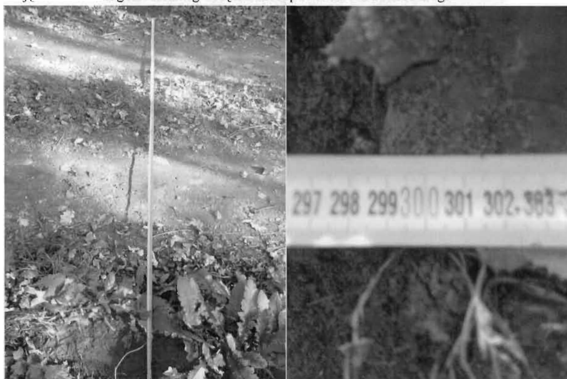
Zdjęcia nr 3 – Droga Białobrzeg – Łąki – nieodpowiednia szerokość drogi.
